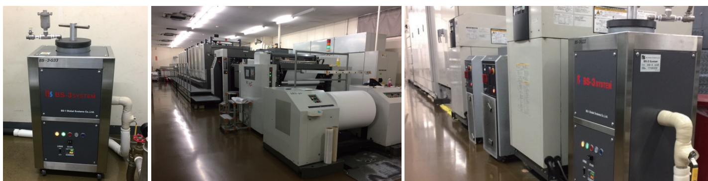
インキローラー専用 菊全8色機用 BS-3・G33 京都市伏見区(株)グラフィック殿 第2工場 10台設置
