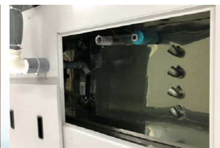
⑧ [設置後] インキローラーチラータンク
